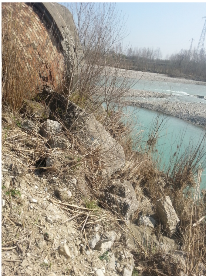
Foto 3: fondazione e parte della seconda pila del vecchio ponte, con inizio difese spondali
